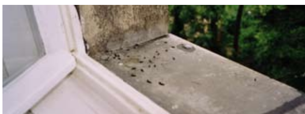
Kotkrümel auf der Fensterbank unter einem Quartier
