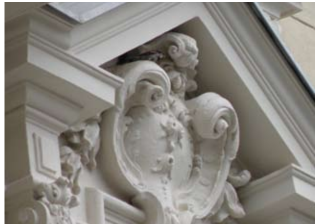
Spatzennest hinter saniertem Stuckelement
