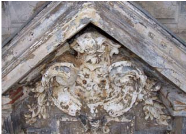
Spatzennest hinter Stuckelement vor der Sanierung
