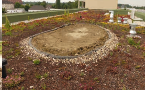
Pfützenanlage auf einem begrüntem Dach in Hannover-Hainholz.
